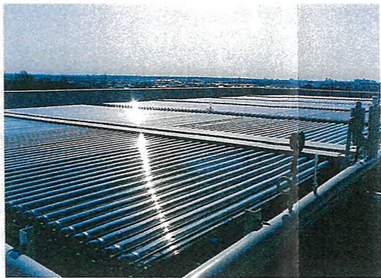
太陽熱パネル(八千代市福祉センター)真空ガラス管形コレクターパネル(2900×1000)54ユニット
