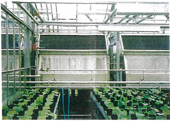
潜熱空調システム(日本バイオエグロケム結城研究所)
