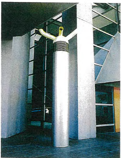
アトリウム空調(日立シビックセンター)自動首振り機構付きポール型吹出口
